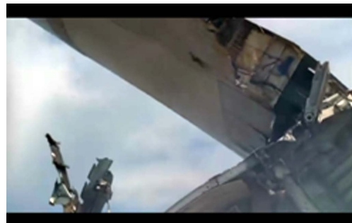
Figura 2 - Risco de desabamento
